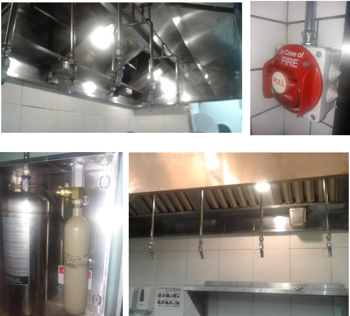
Figura 4.4 Sistemas de extinción en cocinas instalados
