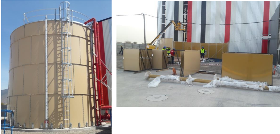
Imagen 4.5, Montajes de estanques instalados por el área
