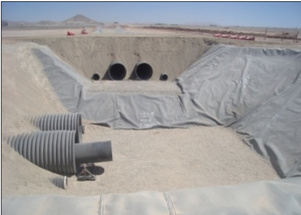
Figura 9, tuberías hdpe, fuente Codelco
