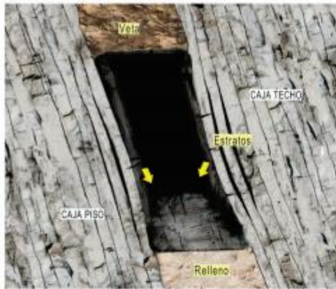
Separación o despegue de los estratos empinados o subverticales, pandeo y caída hacia el vacío minado.
