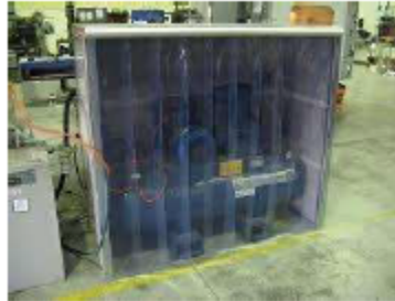
Figura 4. Fotografía ejemplo de encerramiento acústico a compresor.
