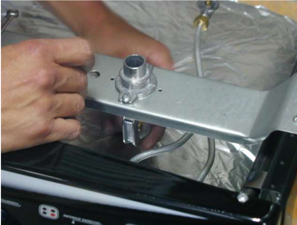
Figura N°6.30: Cambio inyector quemador.
