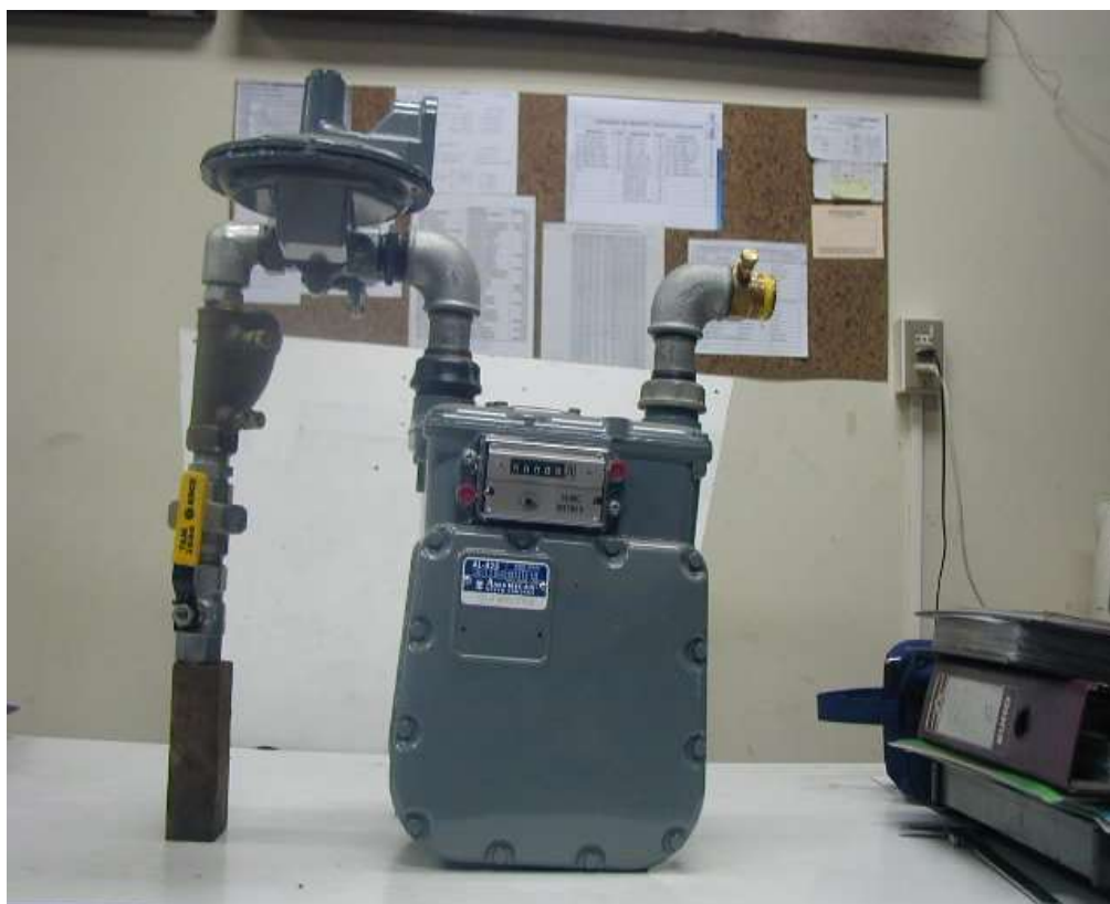
Figura N°6.22: Unidad de regulación y medición.
