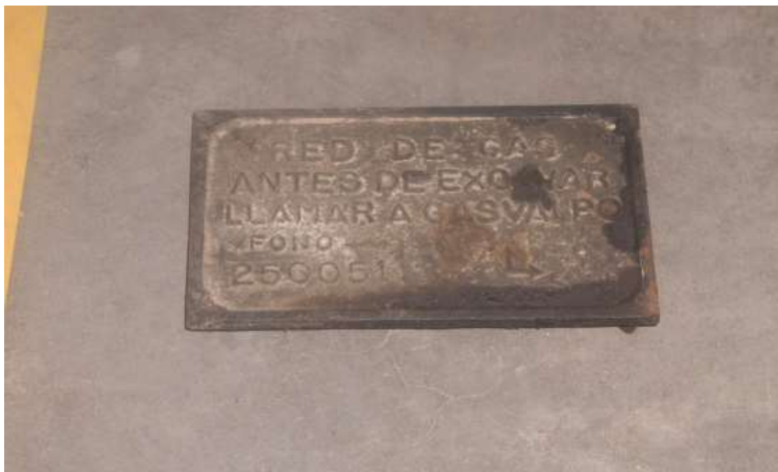
Figura N° 6.18: Placa de advertencia de fierro fundido.
